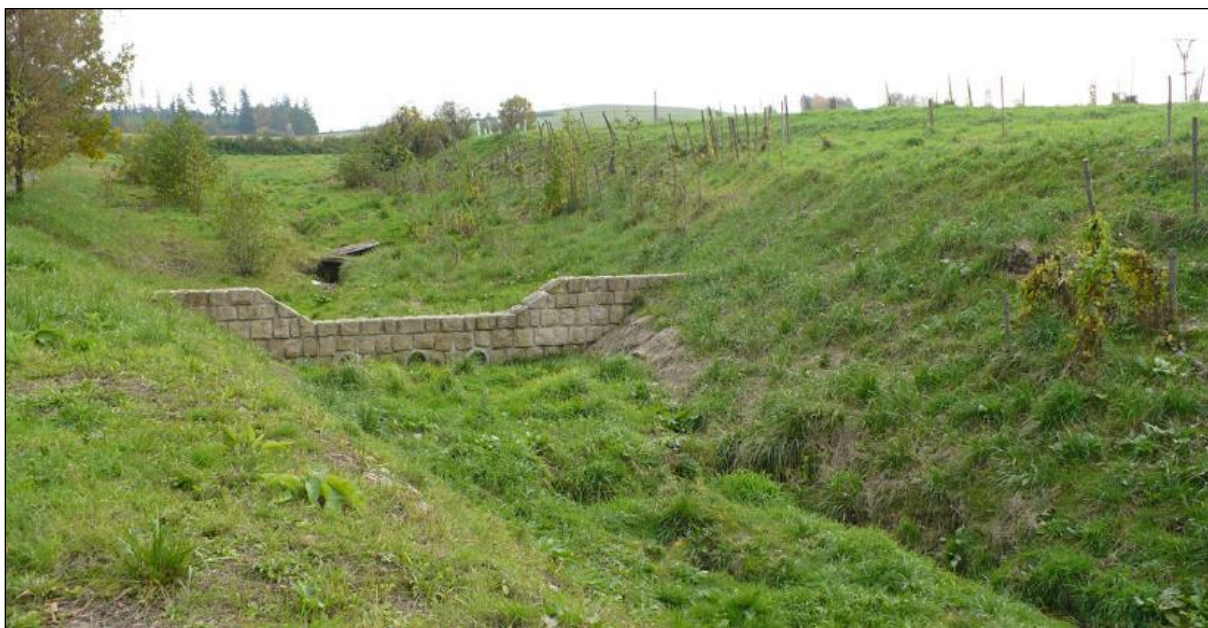
Betonová přehrážka na výrazné údolnici nad zástavbou v Lichnově (zdroj: P. Pavka)
